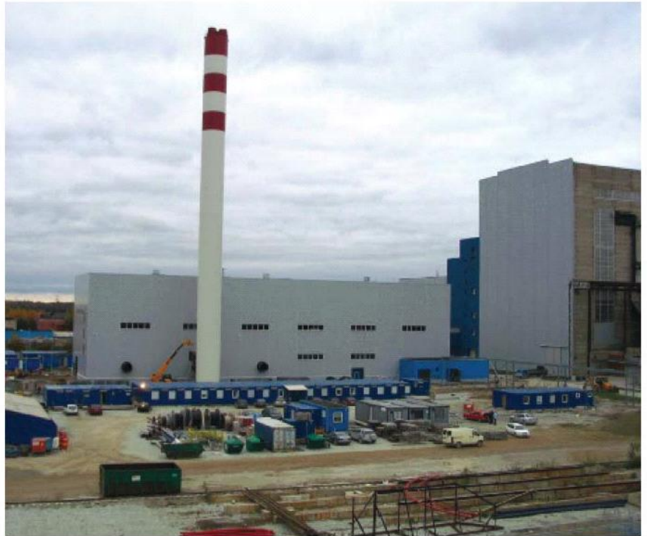
Котельная, г. Нарва.
