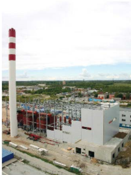
Вид во время строительства котельной г. Нарва. На снимке видны котлы, 3 шт. типа NSTB-117 т/ч.
